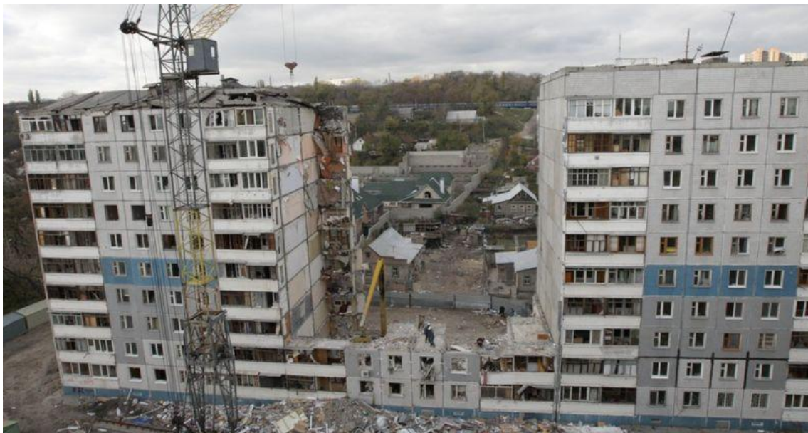
Рис. 3. Ефект прогресуючого руйнування панельного будинку в результаті вибуху газу
