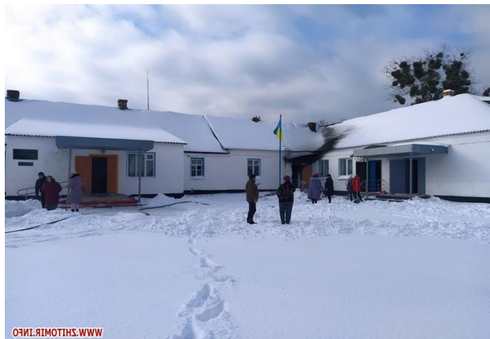
Рис. 4. Пожежа в будівлі дошкільного навчального закладу (с. Харитонівка, Україна)
